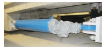
地下ダンパー 8基のダンパーで建物のゆれを収束させます。
