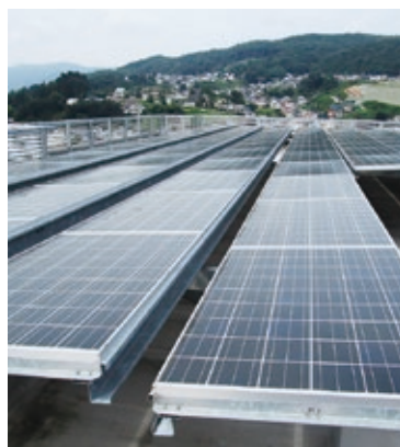
屋上の太陽光発電パネル
